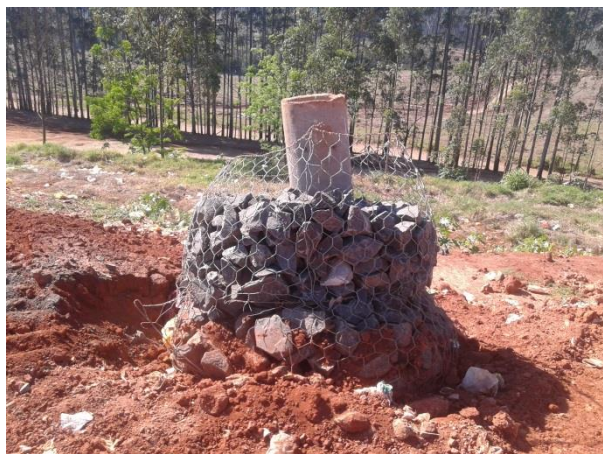
Figura 138: Sistema de drenagem de gases do aterro sanitário.
