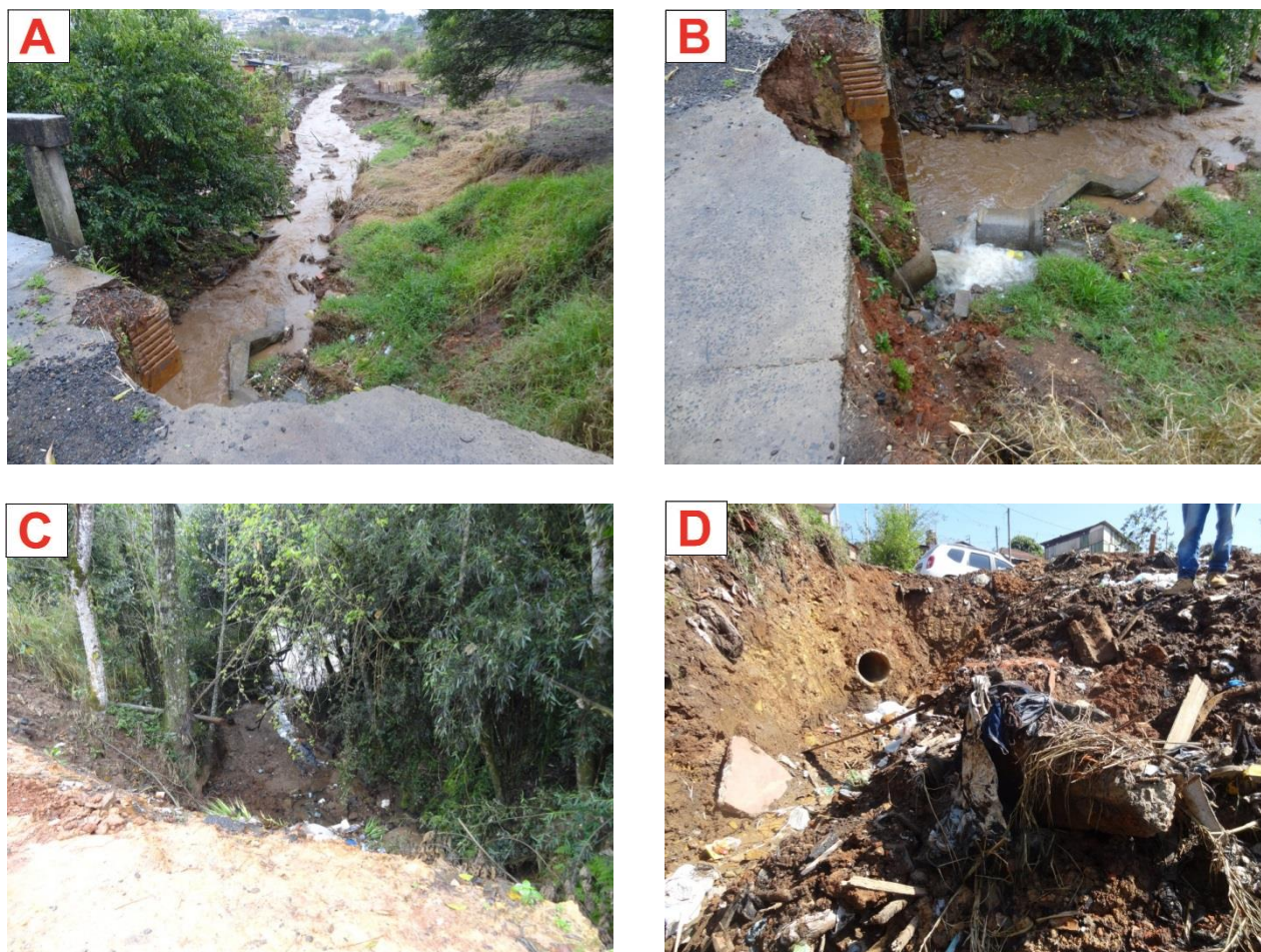
Figura 97: Pontos de erosão nos lançamentos das águas pluviais nos bairros Jardim Alegre (A) e (B); Macopa (C) e Santa Rita (D).
