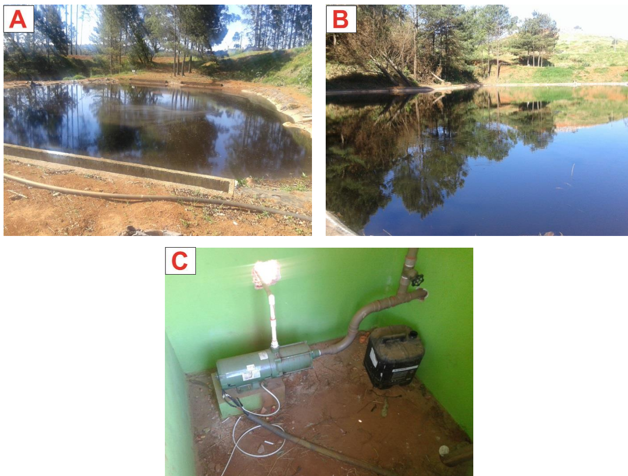
Figura 137: Lagoas anaeróbia (A) e facultativa (B) de tratamento de chorume e bomba de recirculação (C) do aterro sanitário.
