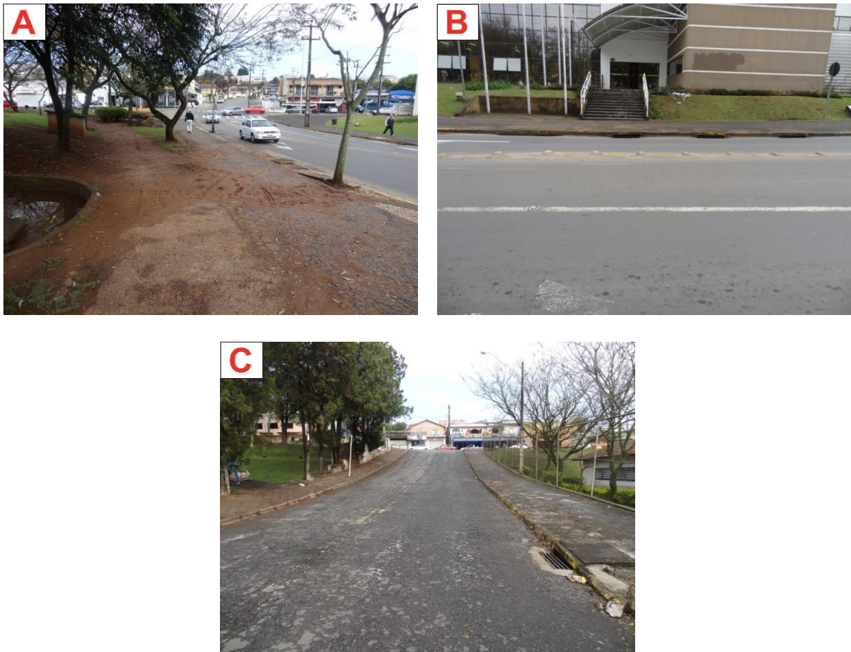
Figura 103: Exemplos de ruas com pontos baixos em Telêmaco Borba em frente à Secretaria de Educação (A) e (B); em frente a Praça da Concha Acústica (C).
