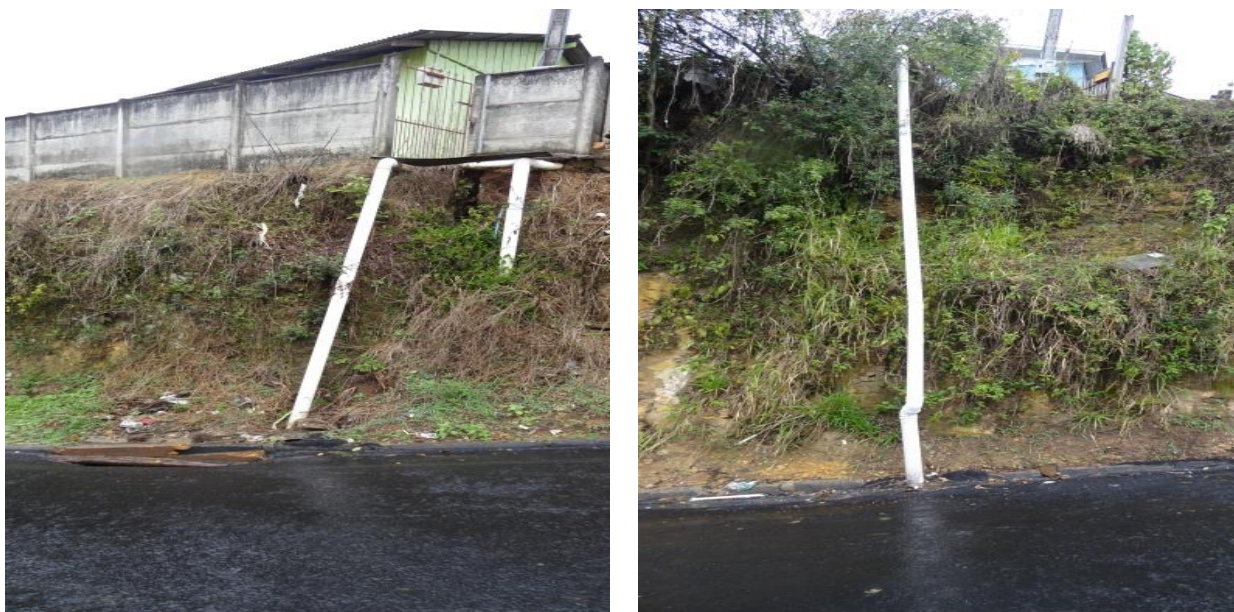
Figura 86: Fontes pontuais de lançamento inadequado de esgoto no bairro Vila Esperança.
