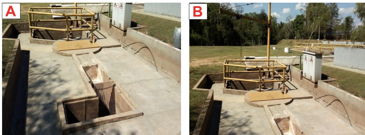
Figura 80: ETE Uvanaral, gradeamento (A); vista geral (B).
